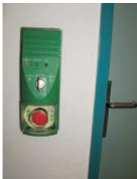
Funktionieren in einem Ereignisfall meine Installationen?
