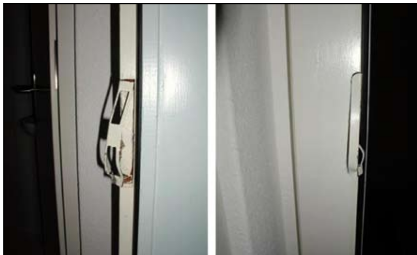
Leichtes Spiel bei ungesicherter Tür: Einbruch ohne Werkzeug! Einbruchsspuren sind kaum sichtbar. Bild: BST Sicherheitstechnik AG
